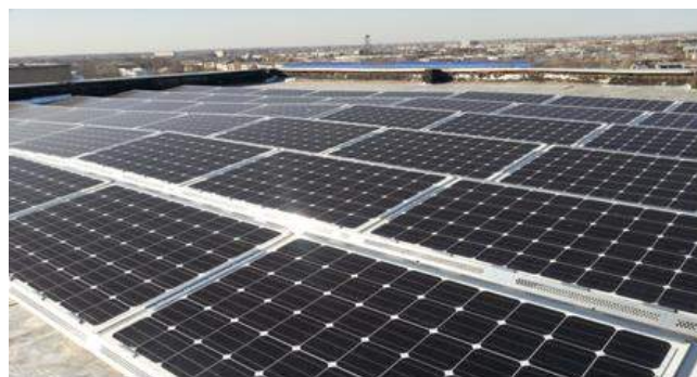
59-rasm. 20 kVt quvvatli quyosh fotoelektrik stansiyasining umumiy ko‘rinishi
