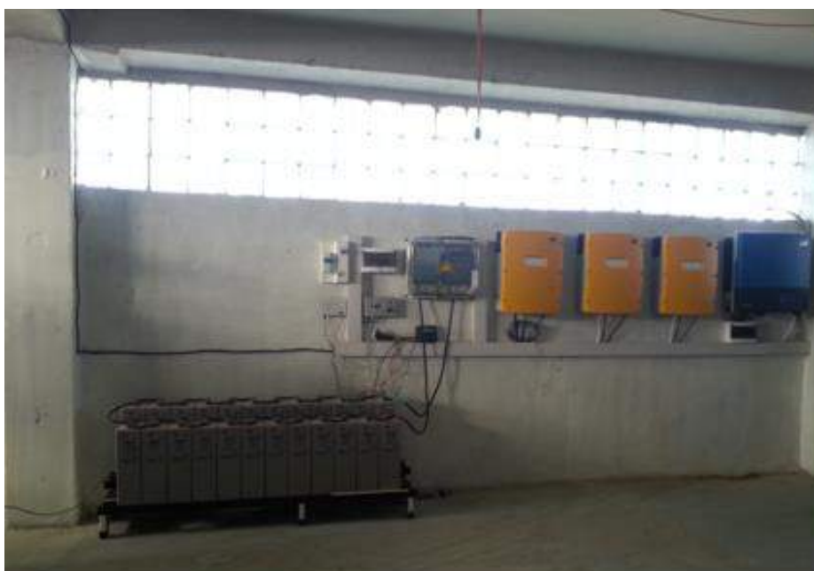
60-rasm. 20 kW quvvatli FES energetik boshqaruv bloki va nazorat qurilmalari
